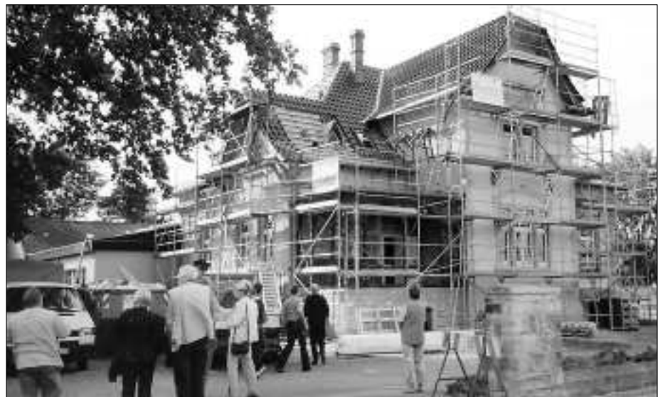
Die „Villa Schenkemeyer“ in Groß Dungen wird vom neuen Eigentümer, dem AWO-Kreisverband Hildesheim-Alfeld, grundlegend saniert und zu einer modernen Sozialstation umgebaut. Sie soll am 1. Oktober eingeweiht werden.
