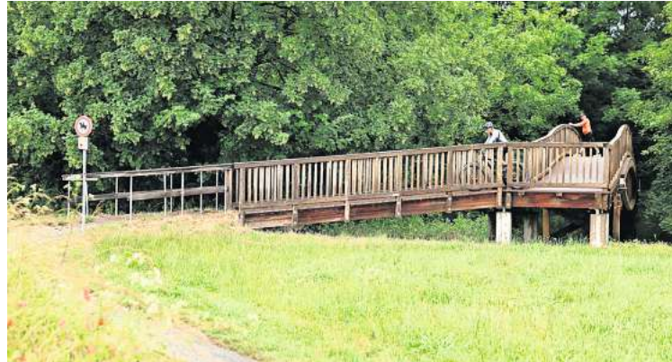
In die Jahre gekommen: Lavesbrücke bei Groß Düngen. FOTO: JULIA MORAS
